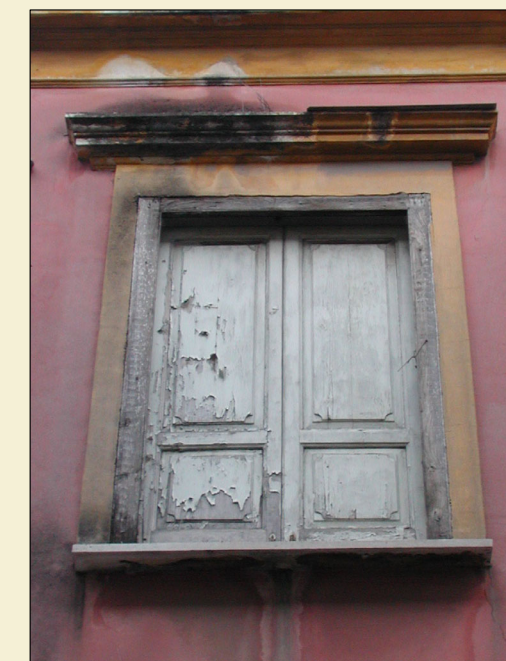
3. Il degrado degli infissi originari in legno: particolare del sistema oscurante
