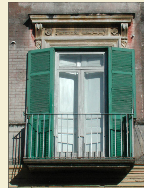
3. Infisso interno in legno di colore bianco a due ante, con sopralluce fisso e sistema oscurante interno ed esterno
