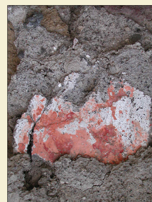
7. Tracce originarie di colore rosso coperte da intonaco cementizio
