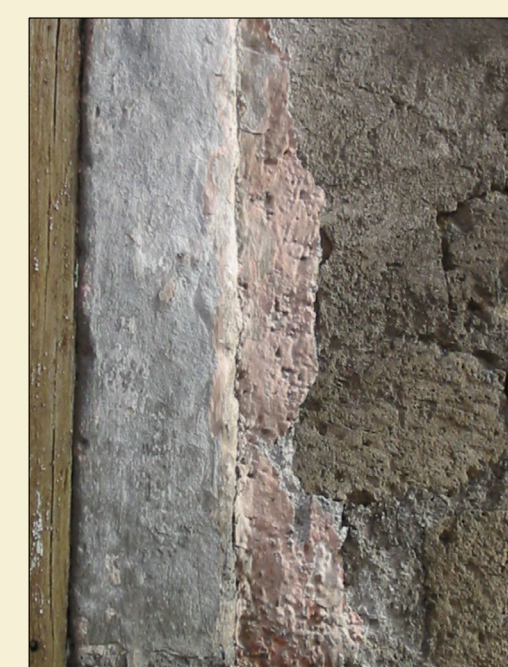
6. Tracce di colore in prossimità degli elementi in rilievo
