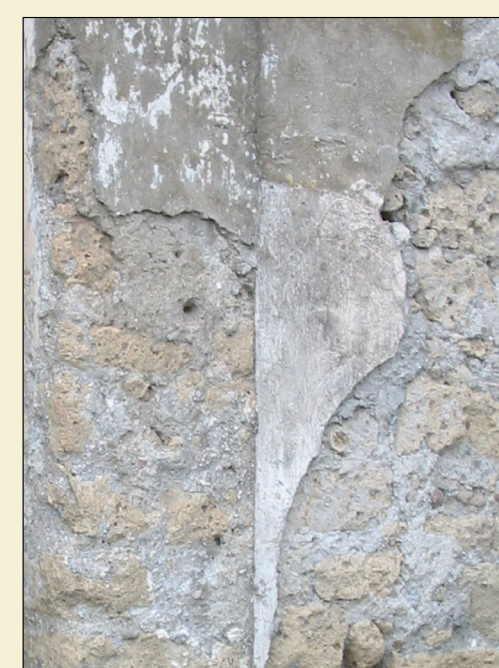
3. Esempio di distacco parziale dell'intonaco
