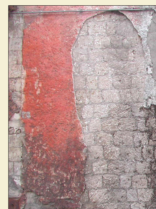
5. Evidenti fenomeni di distacco di intonaco
