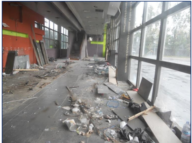
Dettaglio interno ex locale ristorante, stato di degrado
